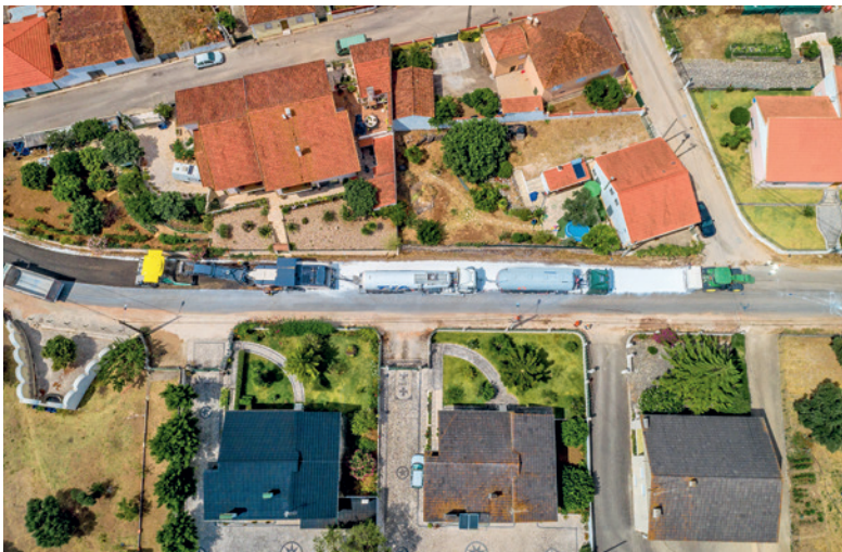
Abbildung 8: Monsanto in Portugal: So sieht effiziente und kostengünstige Instandsetzung aus
